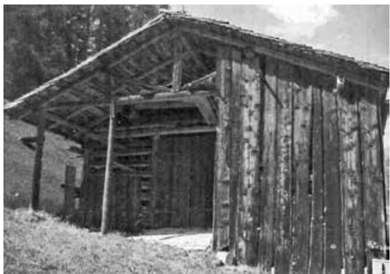
Nebenstall in Gortipohl/Schattenort - Förderprojekt 2018, Sanierung im Jahr 2019 zugesagt.
